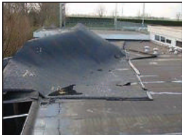
SCHADE PLAT DAK
